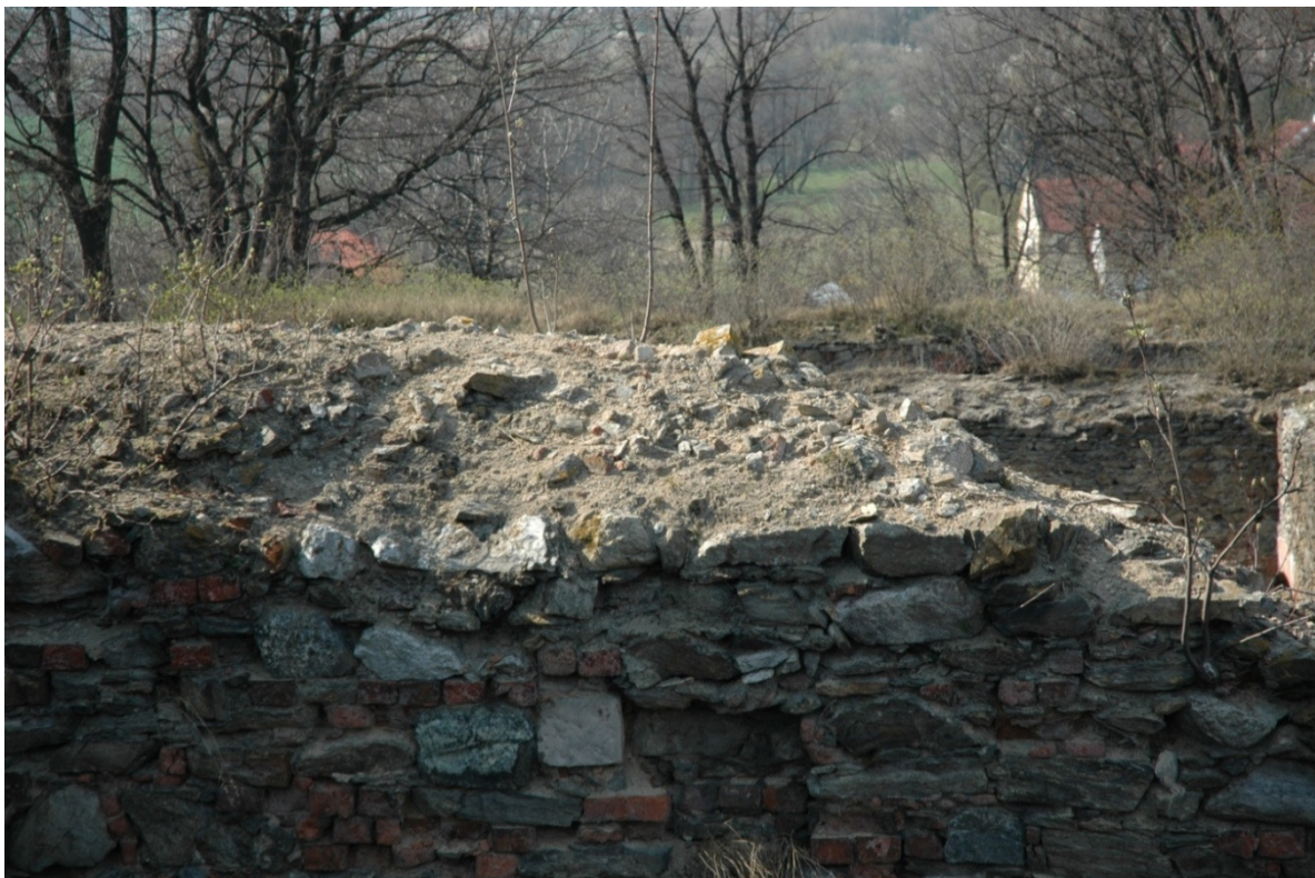
Fot. 24. Zaprawa mocno skorodowana z licznymi ubytkami materiału w koronie muru.
