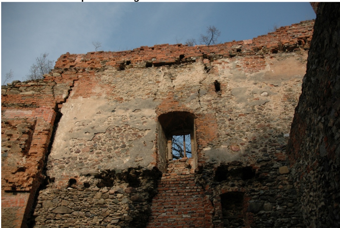
Fot. 35. Ceglana korona muru z licznymi ubytkami i skorodowaną zaprawą.
