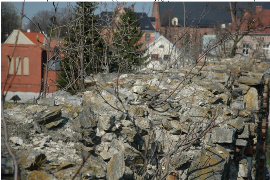
Fot. 5. Na koronie murów widoczne rozległe, miejscami wgłębne ubytki masy muru, kamienie poluzowane, ze znacznie wykruszonymi i wypłukanymi spoinami lub luźno leżące, nie związane zaprawą.
