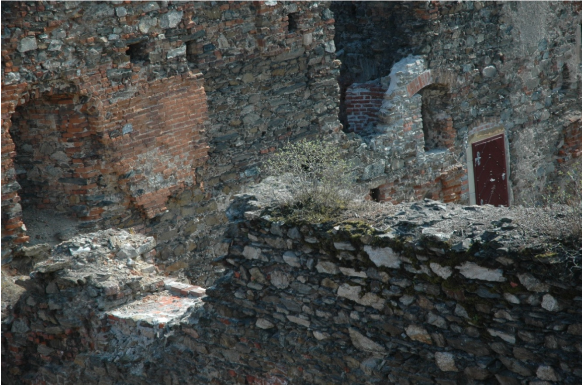
Fot. 28. Część korony muru wymagająca wyrównania do poziomu ściany sąsiadującej w celu wykonania wieńca żelbetowego. W miarę możliwości należy użyć zachowany kamień i starą cegłę a do spajania użyć zaprawy wapienno – piaskowej (trassowej) lub zaprawy na białym cemencie.
