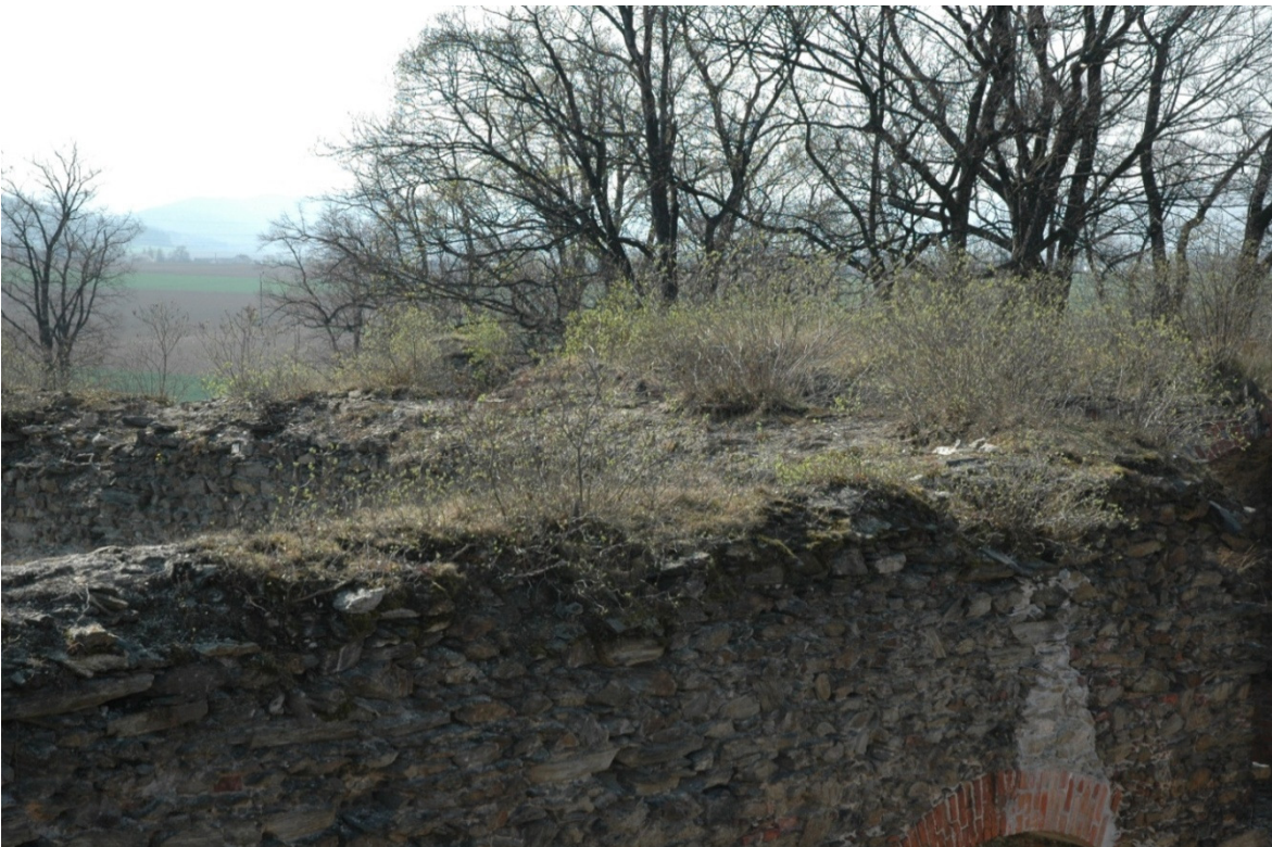
Fot. 29. Warstwa humusu zalegająca na części korony muru wraz z porastającą go roślinnością.
