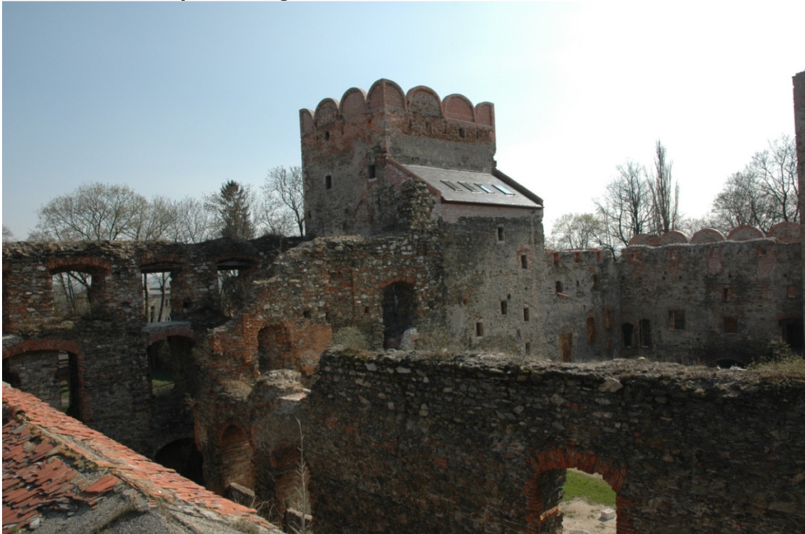
Fot. 26. Liczne ubytki materiału w koronie muru.
