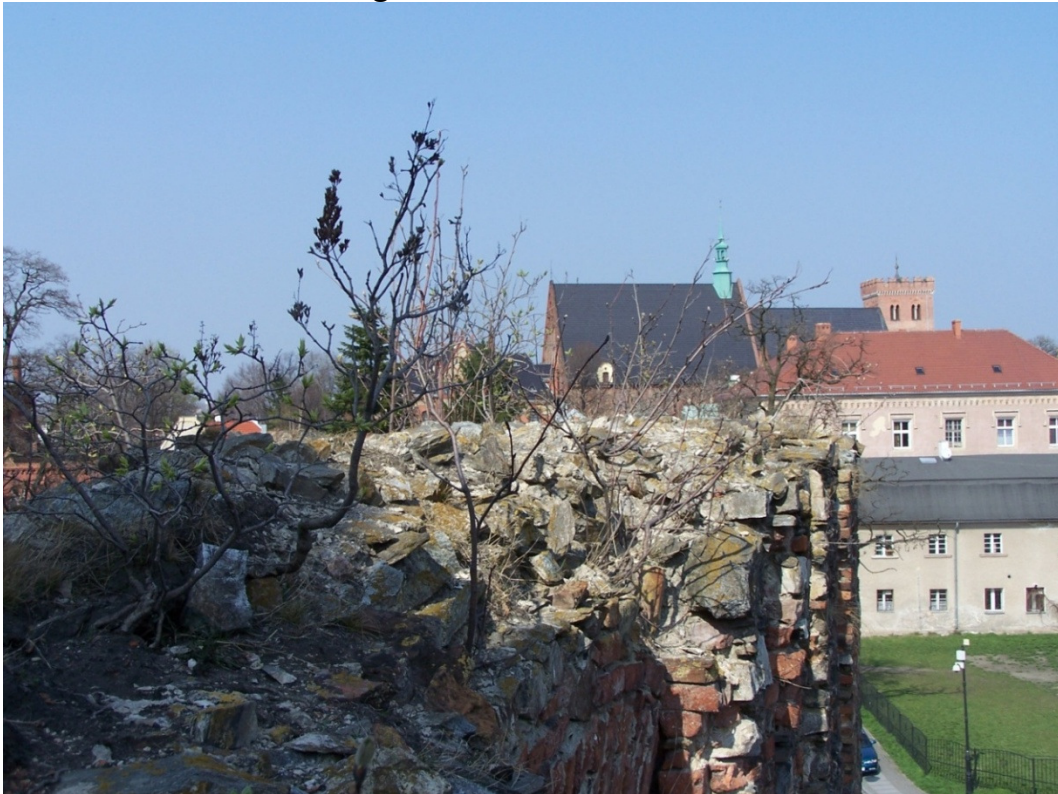
Fot. 4. Korona porośnięta obficie roślinnością (trawa krzewy, głęboko zakorzenione drzewka).
