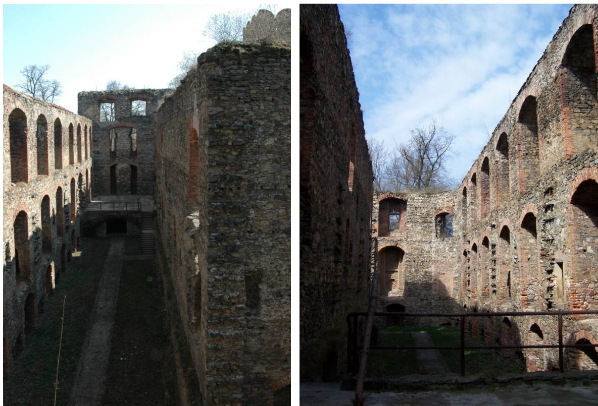
Fot 2,3. Widoczne skrzydło północne. Część wewnętrzna murów pozbawiana stężeń poprzecznych, brak jakichkolwiek ścian i stropów.
