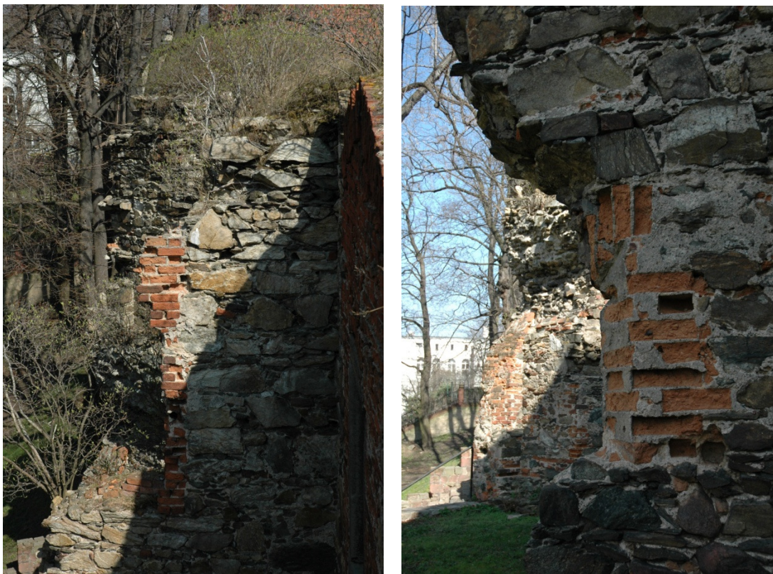
Fot. 37. Ściana bastei wymagająca częściowej odbudowy. Należy zaprojektować i wykonać podparcie dużego nawisu muru. Konieczne jest szczególne, estetyczne rozwiązanie, które będzie harmonizowało z zachowaną ruiną.
