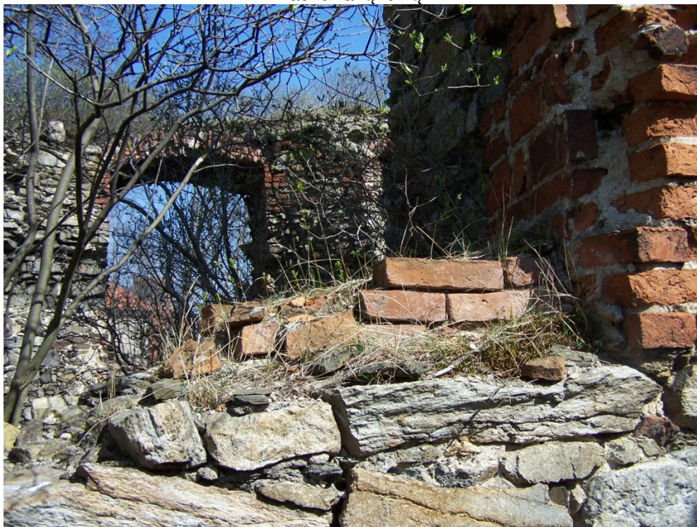
Fot. 38. Luźno leżące cegły w większości skorodowane powierzchniowo i włąębnie.
