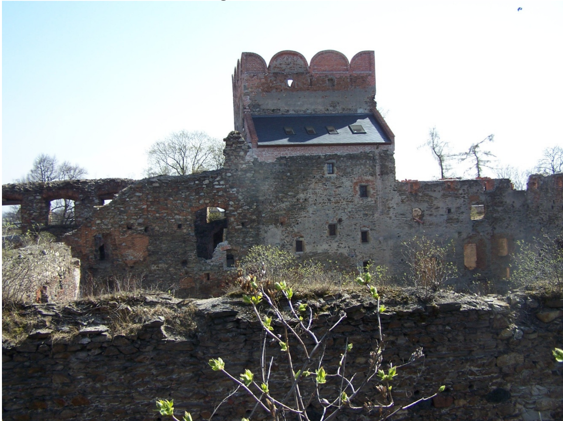
Fot. 30. Znaczne ubytki materiału kamiennego w koronie muru.
