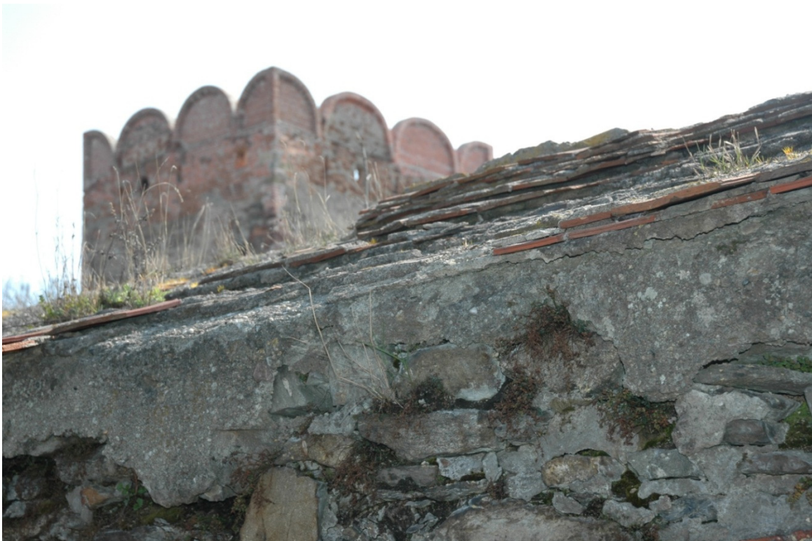
Fot. 13. Wyciek betonu spowodowany zastosowaniem nieuszczelnego szalunku.
