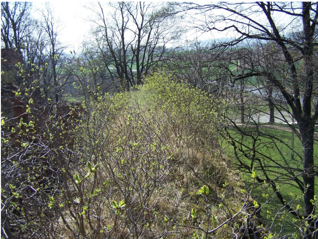
Fot. 14,15 Korona porośnięta obficie roślinnością wzrosłą na zalegającym na murach humusie. Należy usunąć wszystkie naleciałości roślinne. Nie dopuszcza się wrywania głębokich korzeni gdyż może skończyć się to rozerwaniem fug. Pozostawione w masie muru korzenie należy opryskać herbicydem, specjalnym preparatem, który zapobiegne wzrostowi roślinności, nie uszkadzając budulca.
