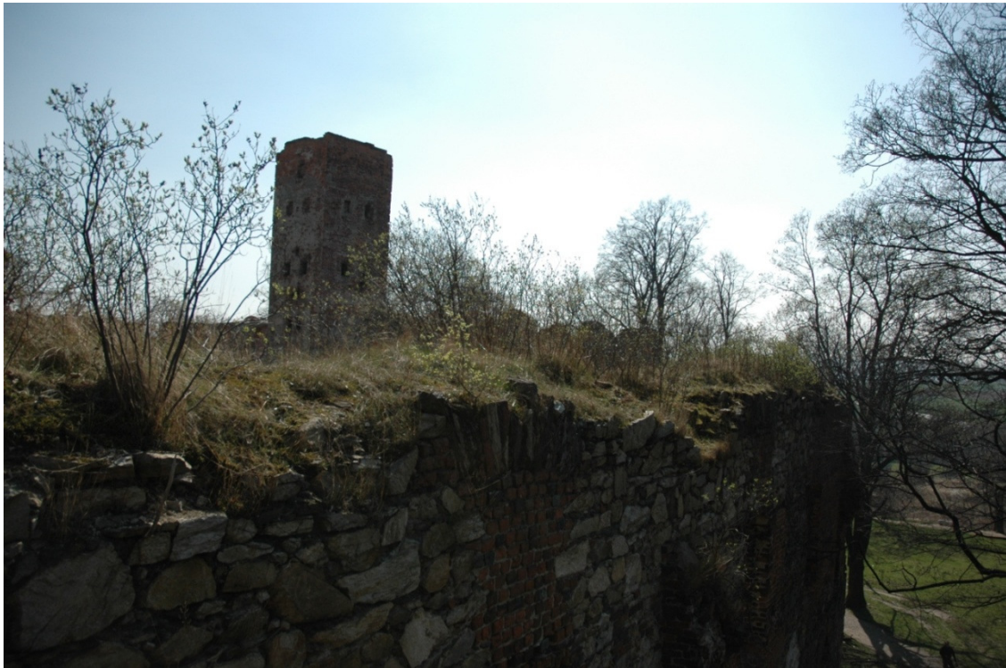
Fot. 16. Rozległe a miejscami głębokie ubytki masy muru.
