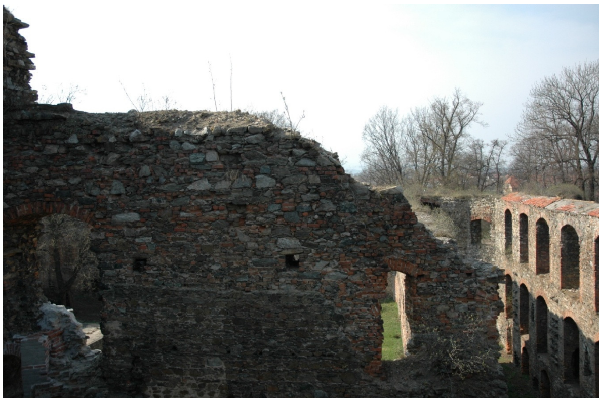
Fot. 25. Ostra zmiana spadku ściany, wymagane wykonanie wieńca żelbetowego dopasowanego do linii zabudowy w celu zachowania zabytkowego charakteru.
