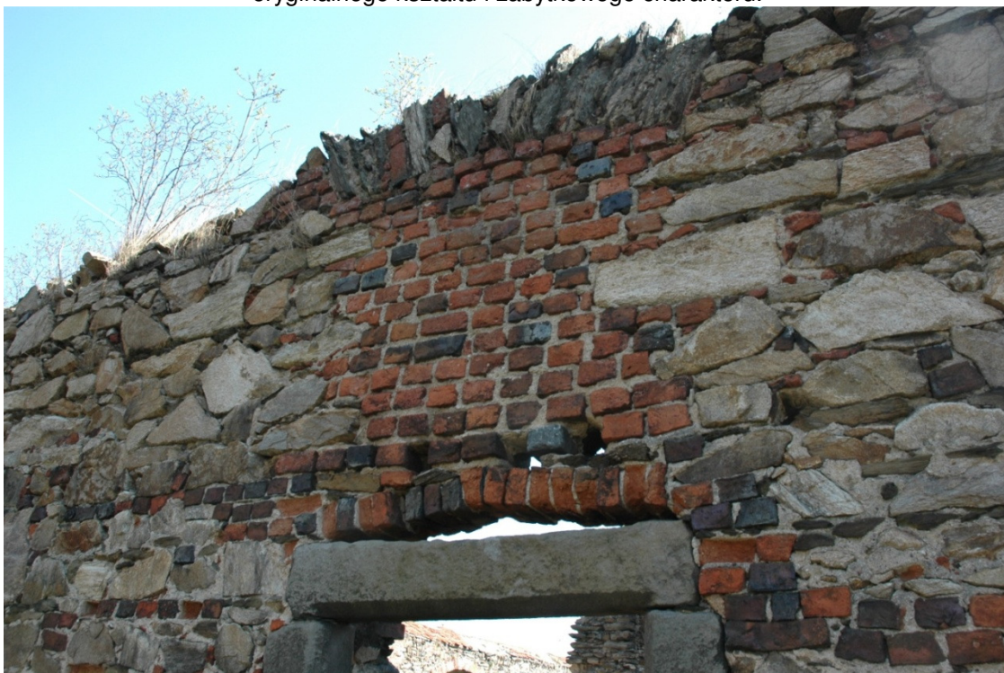
Fot. 21. Szczelina w nadprożu okiennym wymagająca uzupełnienia.
