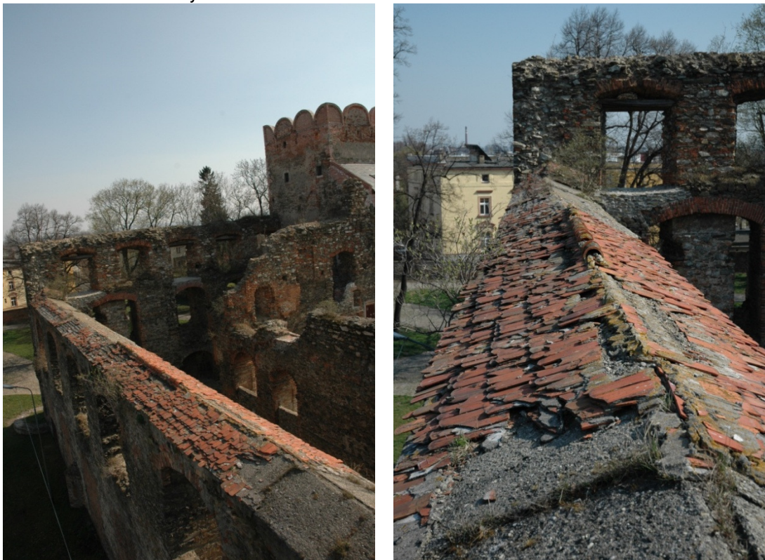
Fot. 11. Pozostałości dachówki karpíówki na betonowej wylewce (reperacja po 1950r.).
