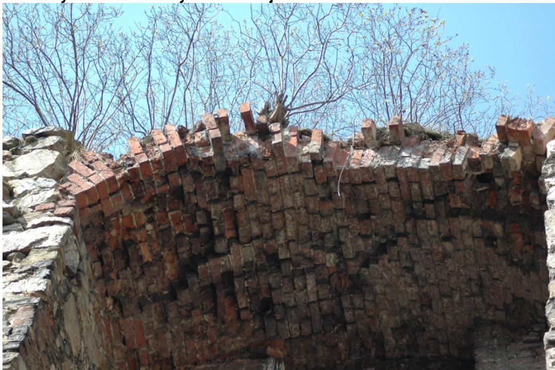
Fot. 20. Łuk okienny z północnej strony muru wymagający rozebrania i odbudowy z zachowaniem oryginalnego kształtu i zabytkowego charakteru.
