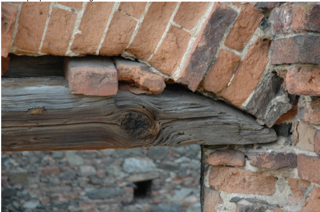
Fot. 9. Detal podparcia okiennego. Należy zaimpregnować drewno (wzmocnienie mechaniczne i zabezpieczenie przed wzrostem mikrobiologicznym), oczyścić i wypełnić pustą przestrzeń pomiędzy murowanym nadprożem a belkami.
