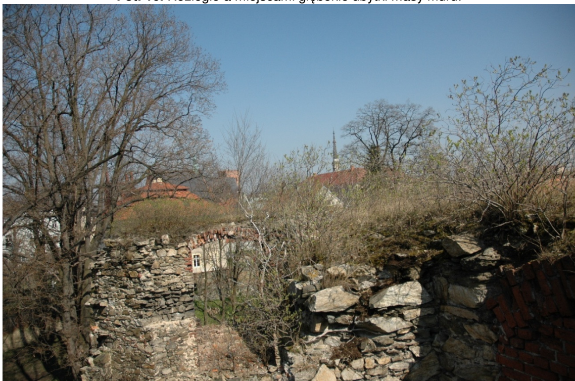
Fot. 17. Połączenie ściany zachodniej ze ścianą bastei, widoczne luźno leżące nie związane zaprawą kamienie.
